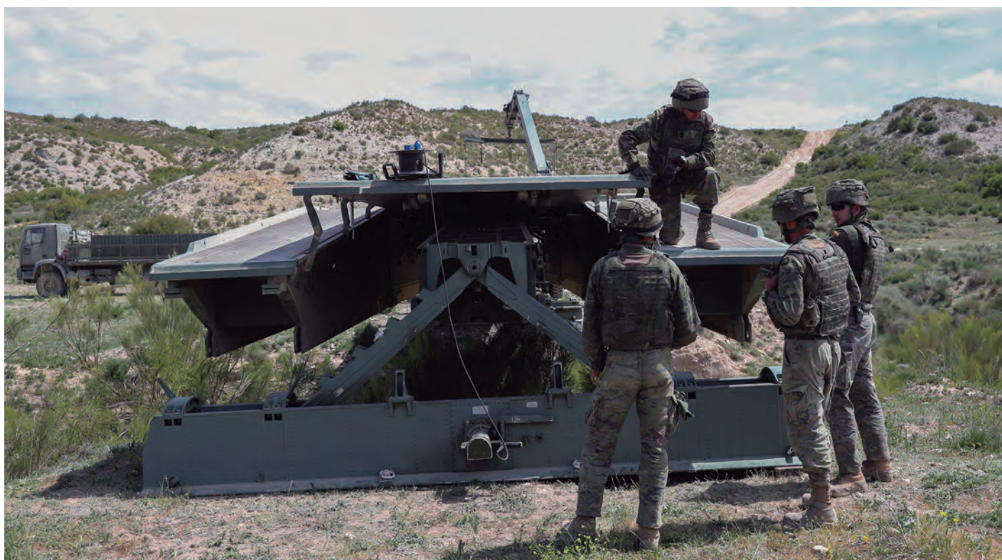
Zapadores de la sección de puentes de apoyo a vanguardia supervisan la instalación de la plataforma Dornier que permitirá salvar una cárcava de 21 metros de ancho y dos de profundidad y reabrir una ruta de abastecimiento.
