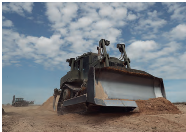
Una empujadora del pelotón de excavación trabaja en la construcción de un foso contra carro.
