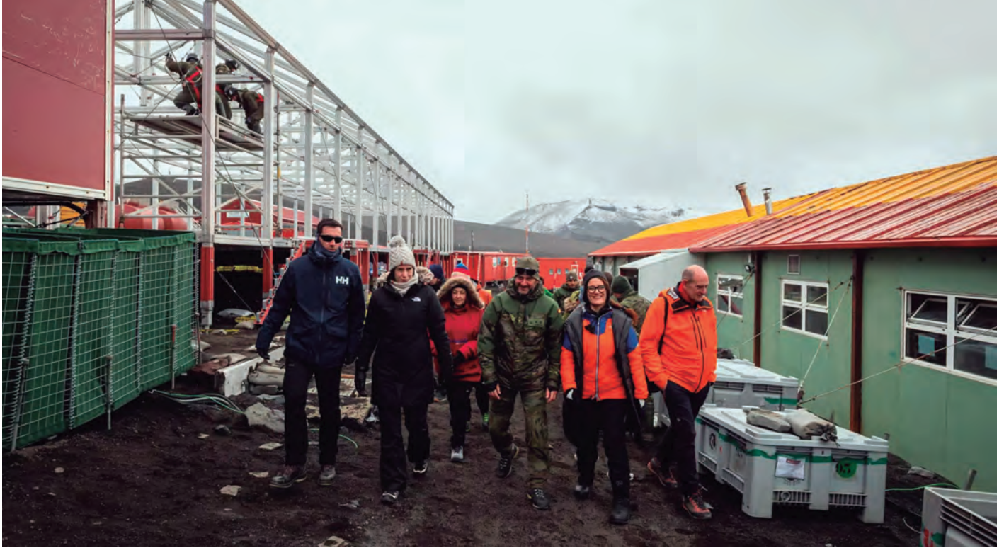
La ministra de Ciencia, Innovación y Universidades, acompañada por el jefe de la Gabriel de Castilla , visita las obras del módulo científico construido en la base.
