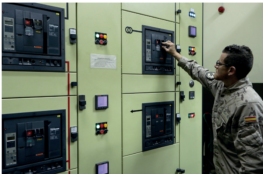
Los equipos de la sala SAI (Sistema de Alimentación Ininterrumpida) controlan la energía que llega al radar para evitar averías.
